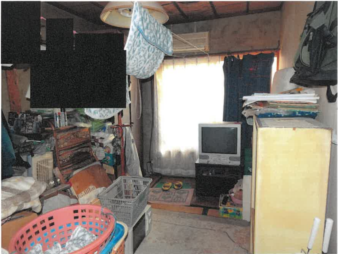
11 天井の雨漏り跡と思われる損傷
