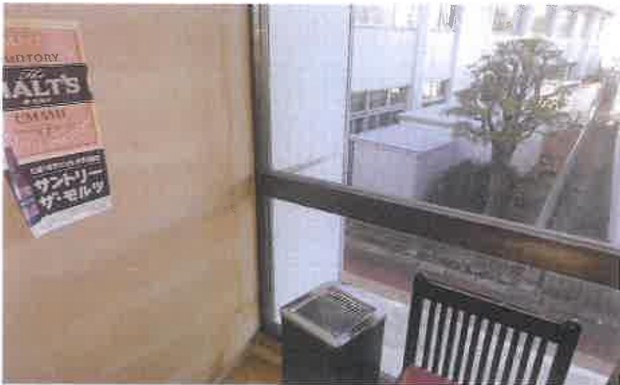
喫煙室の壁クロスの状態
