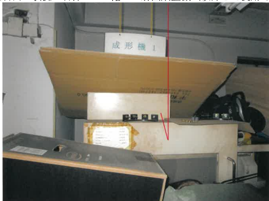
⑭ 建物内の状況 物件4の1階 射出成型機 (故障して使用できない)
