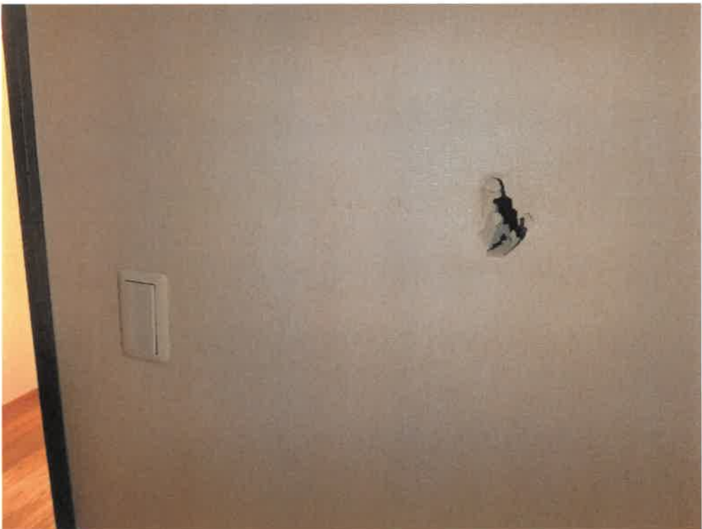
8 物件3建物内部の状況（壁面の損傷（洋室1））
