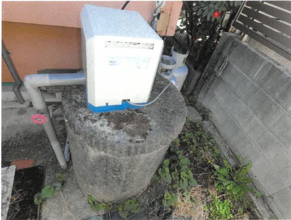
9 物件1 土地に設置された井戸
