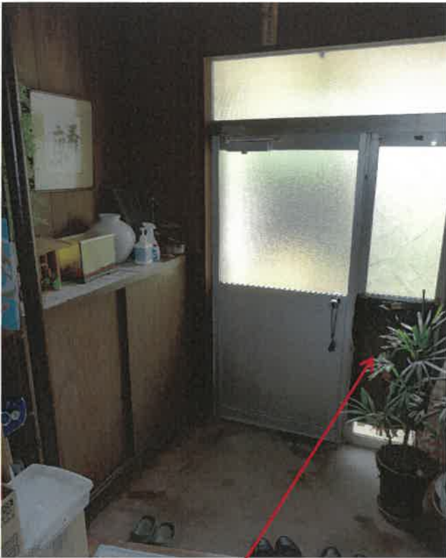
玄関のガラスが割れた部分
