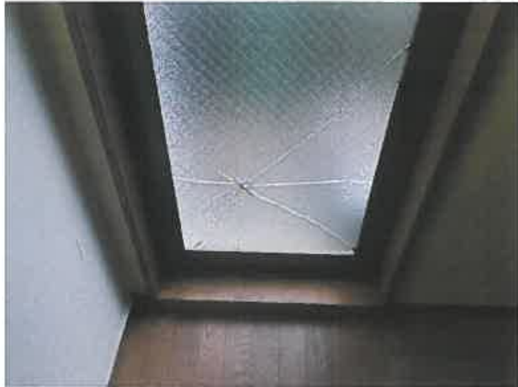
写真11 勝手口扉のガラス
