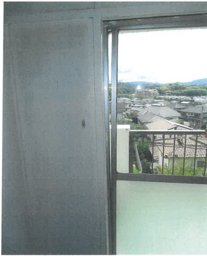
サッシの隙間
