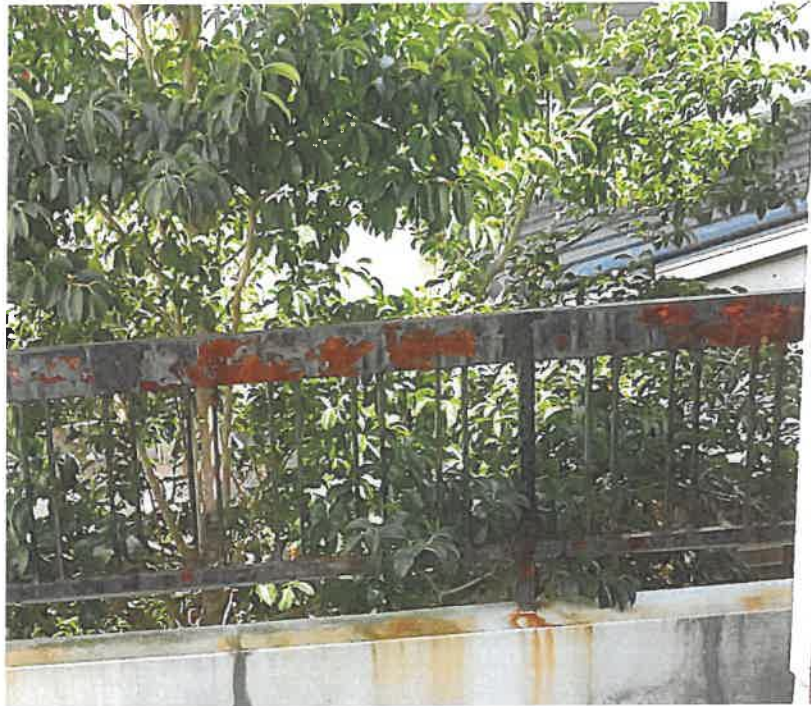
バルコニーの鉄部の腐食(錆び)
