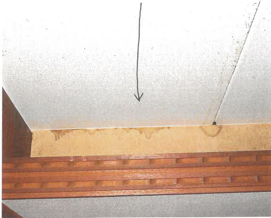
天井付近の雨漏り跡のようなシミ
