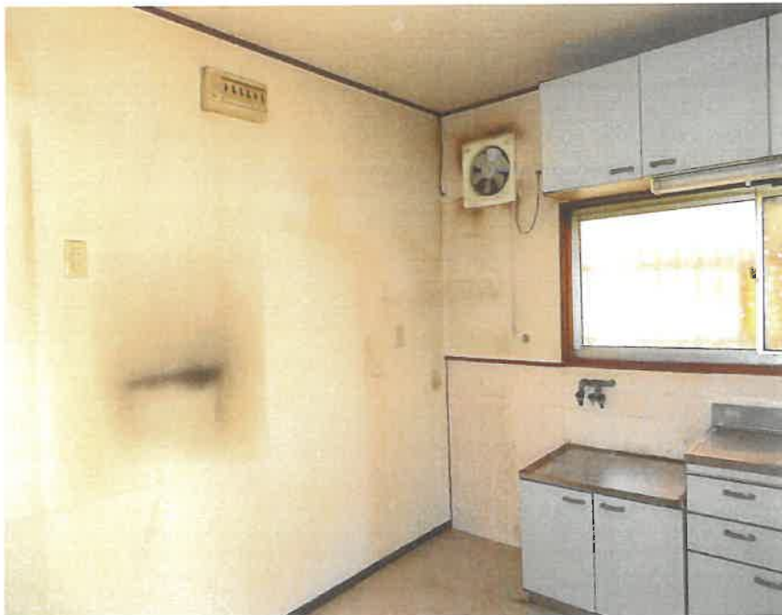
全体的な壁の汚れ
