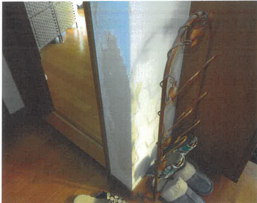
壁の角にあるひっかき傷とクロスの剥がれ
