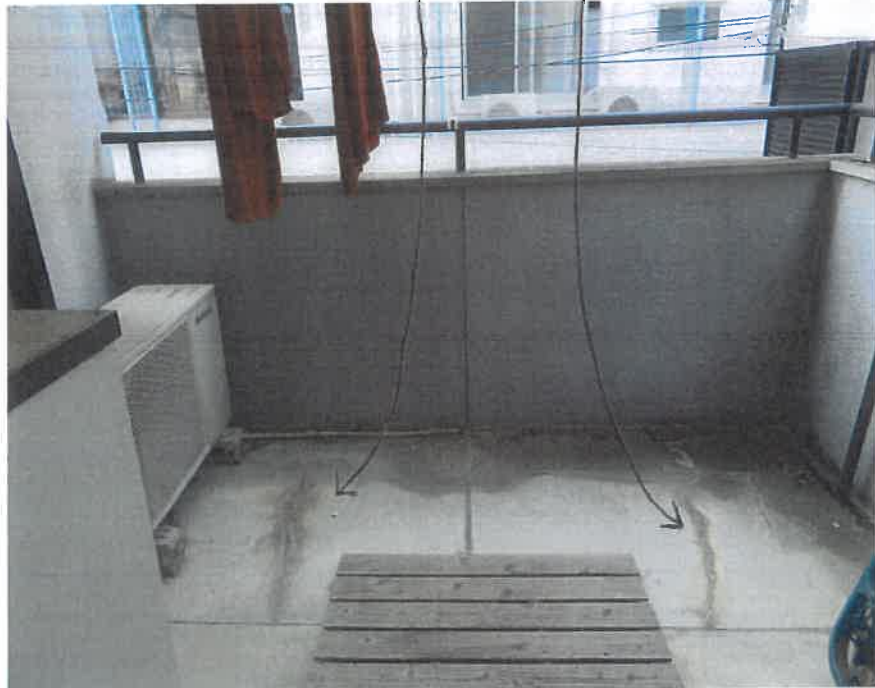
床面にある亀裂のような跡
