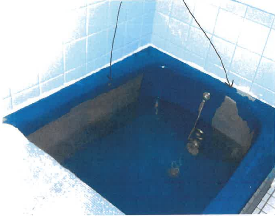
浴槽コーティングの剥離
