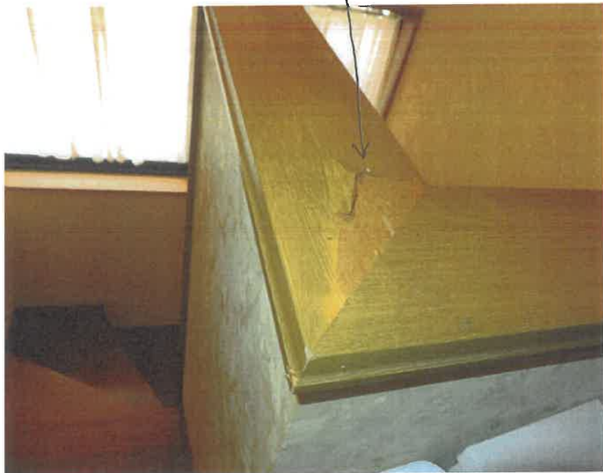
階段を仕切る壁の上の損傷
