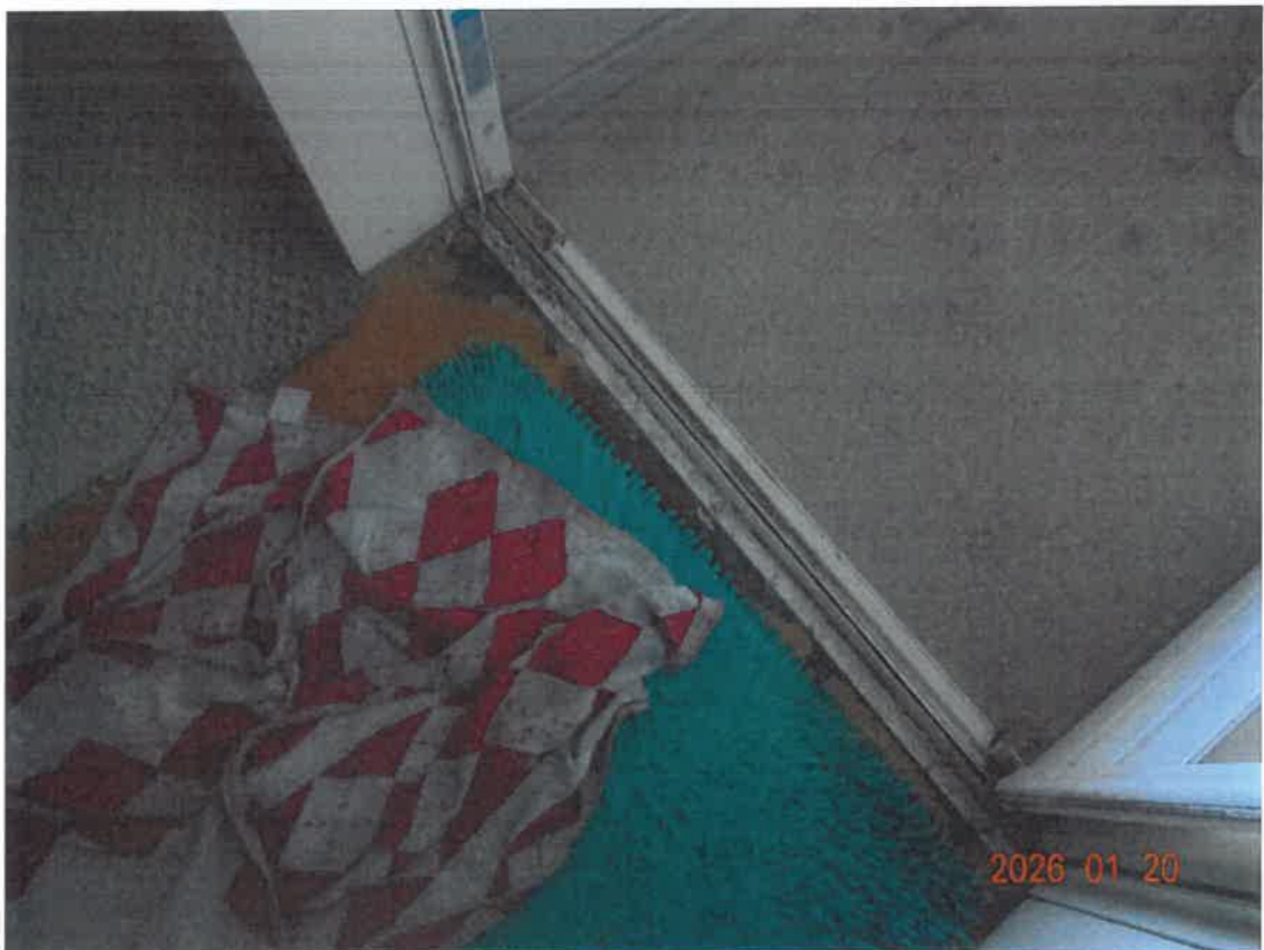
④洗面所の床の黒ずみ
