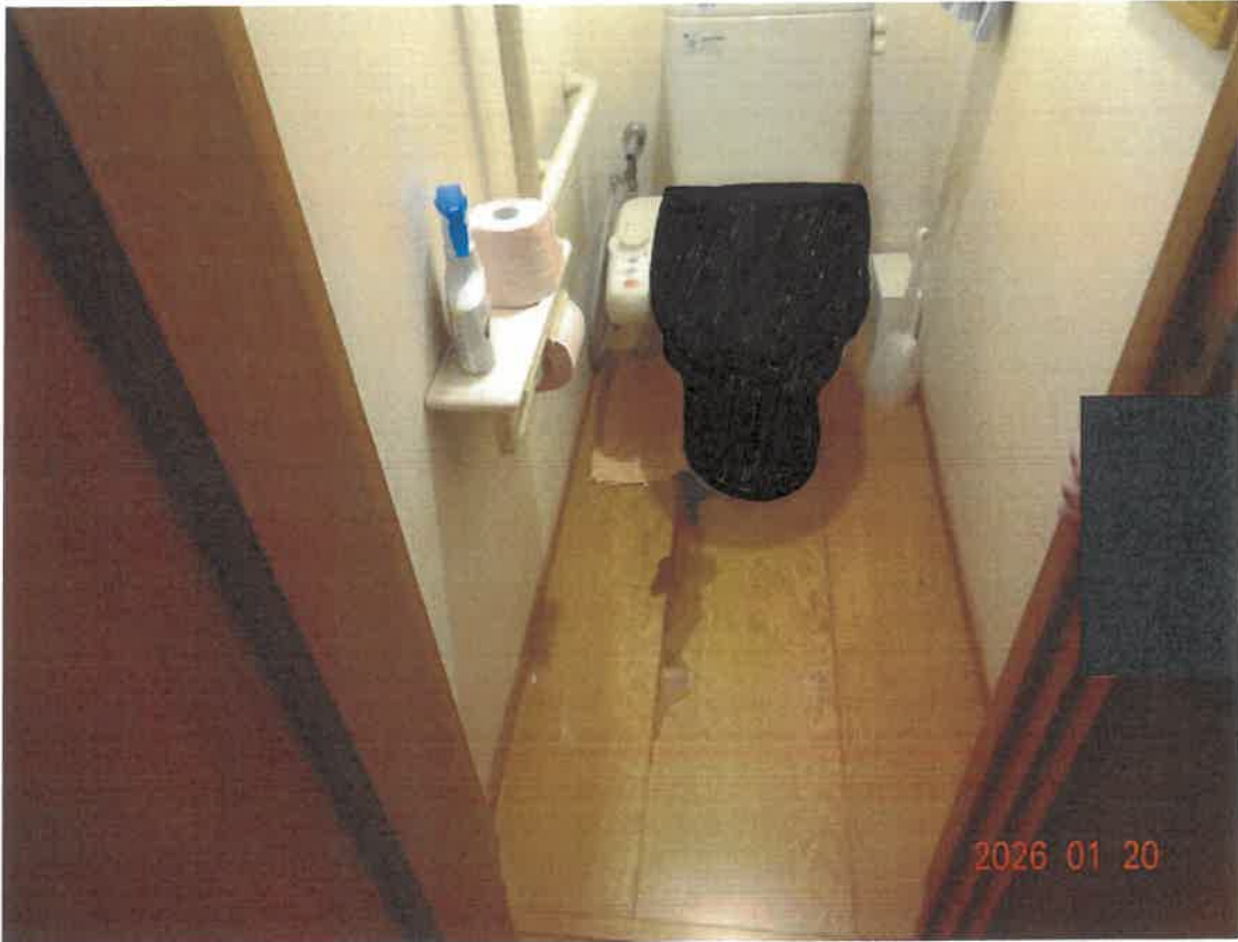
⑤1階トイレの水漏れ
