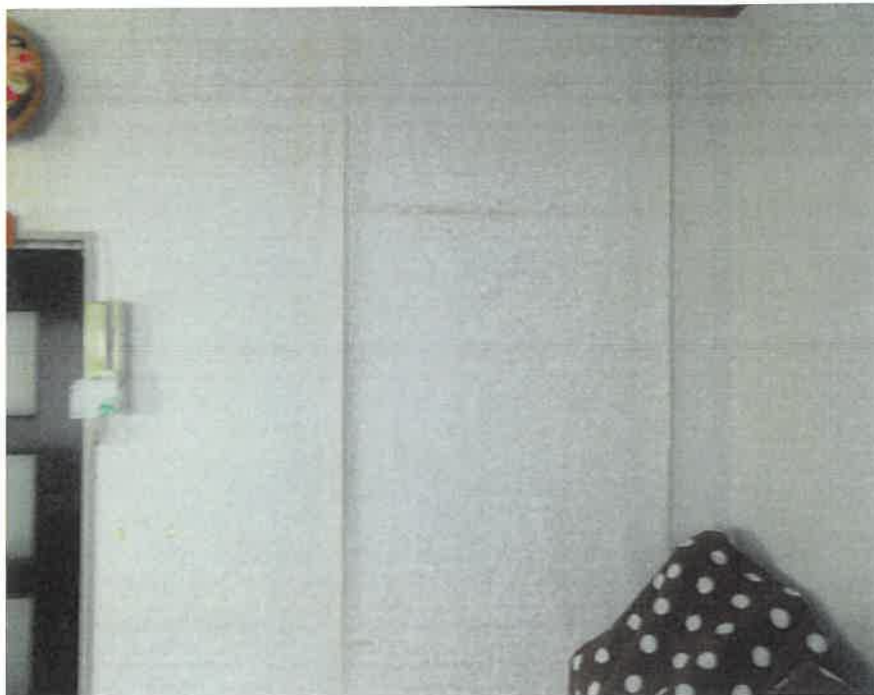
壁クロス剥離による割れ目の線
