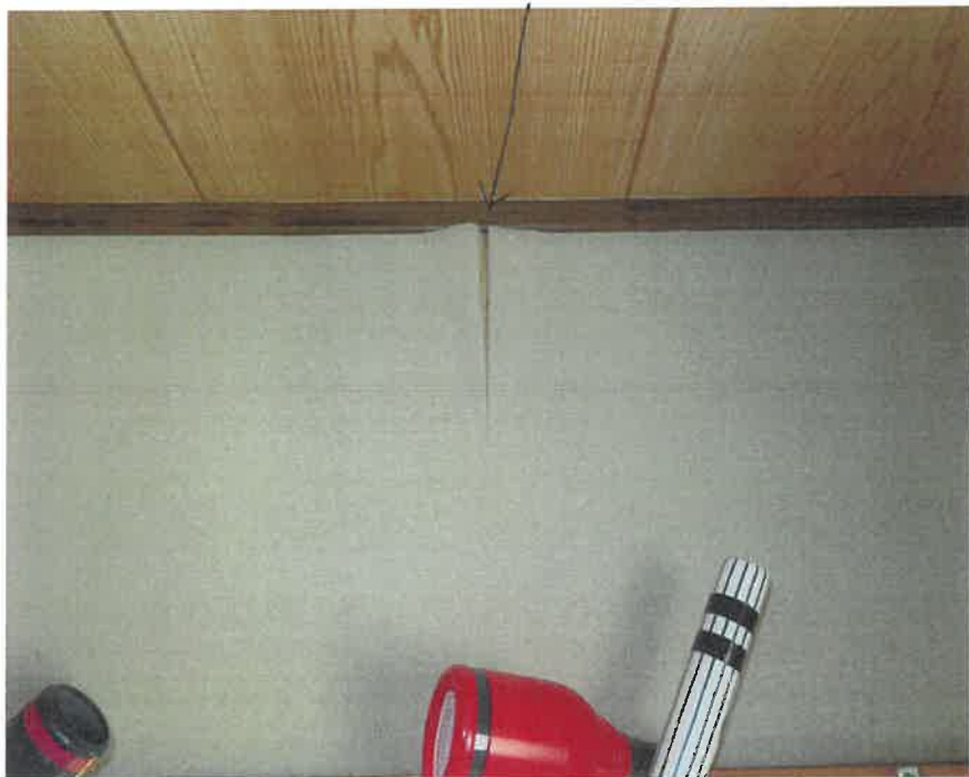
天井付近の壁紙の割れ目
