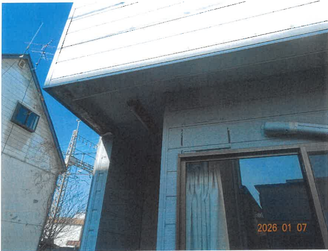
③ 2階ベランダ裏の破損箇所
