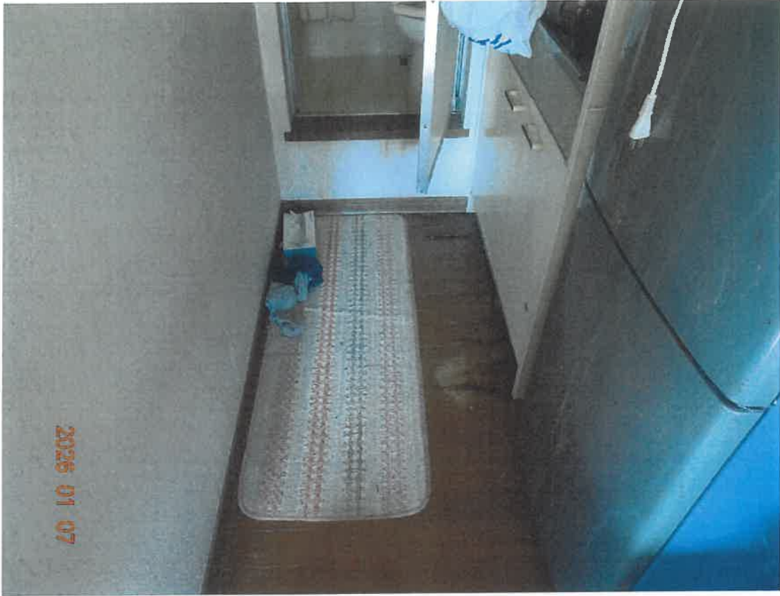
⑮ 3階の床の損傷箇所
