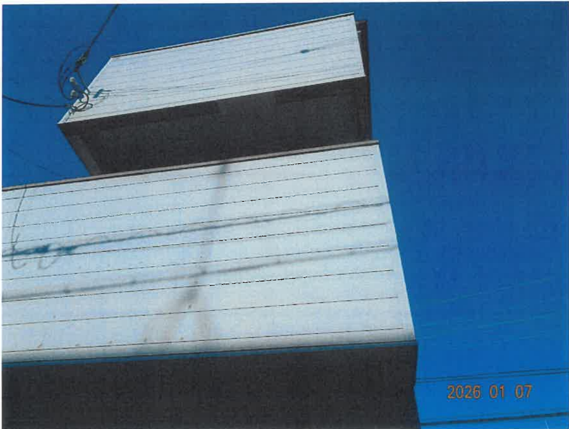
② 3階ベランダ裏の破損箇所
