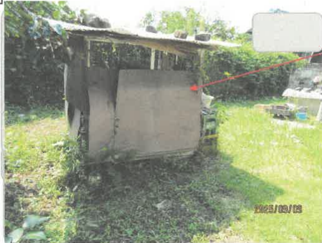
崩れかけた小屋 工作物（動産）
