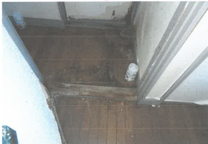
2階の洋室ドア下部及び廊下の腐食の状況
