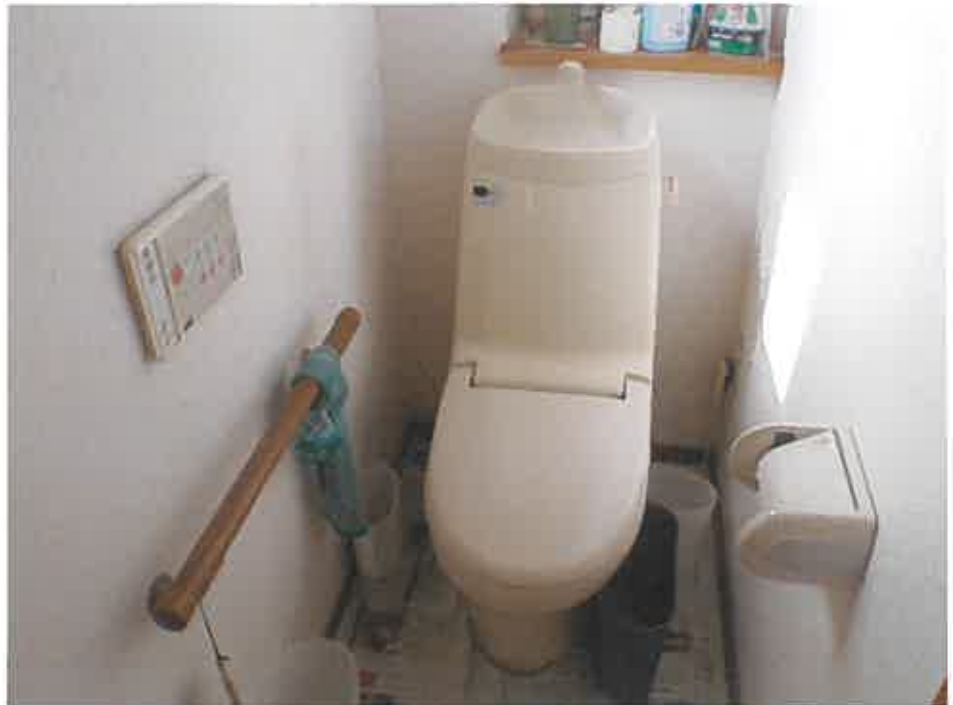
物件3 2階トイレ (使用不能)
