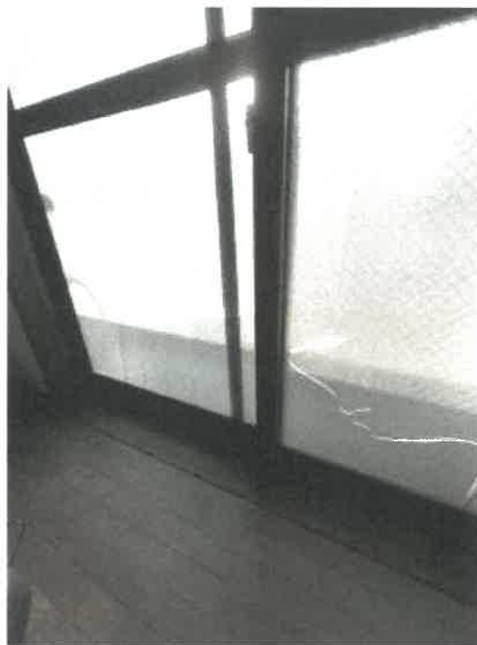
物件2 102号室居室内ガラスのひび割れ状況
