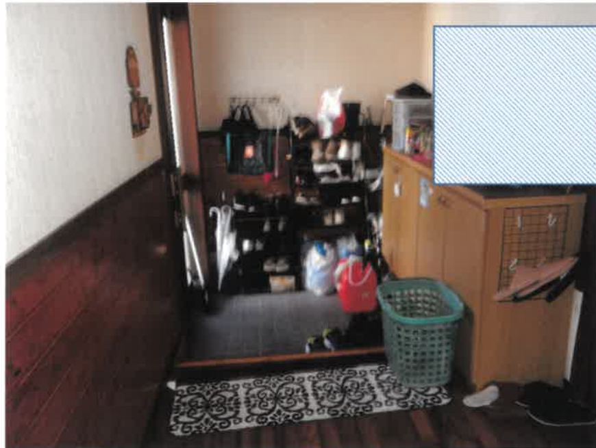
ドアの破損跡
