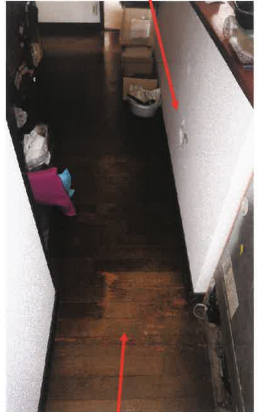
床の劣化状況
