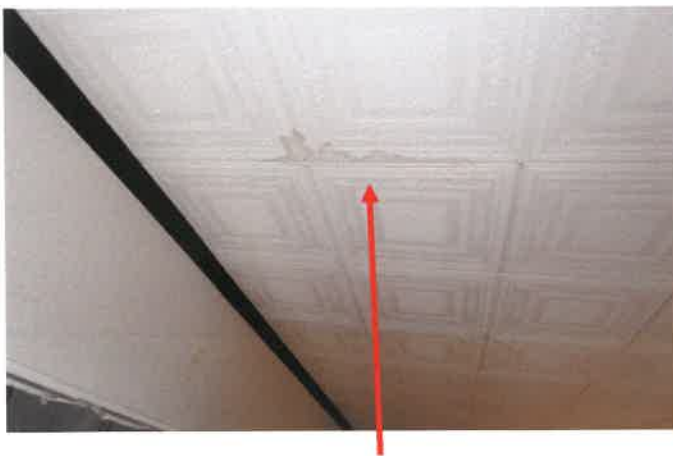
雨漏り跡の状況
