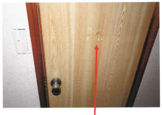
トイレ扉破損の状況
