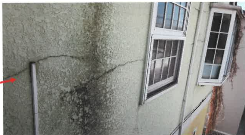
外壁のヒビの状況
