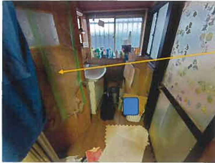
トイレドアの 開閉不具合
