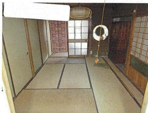
物件4 建物 1階 白蟻腐食跡
