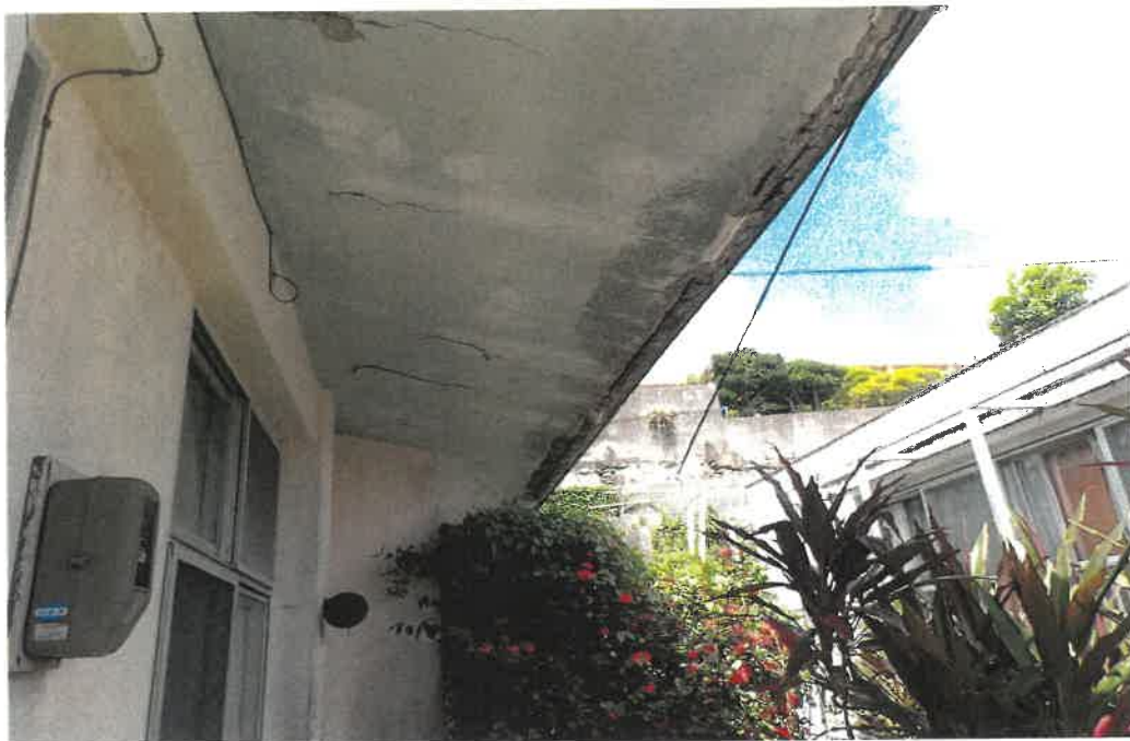
コンクリートの欠落等
