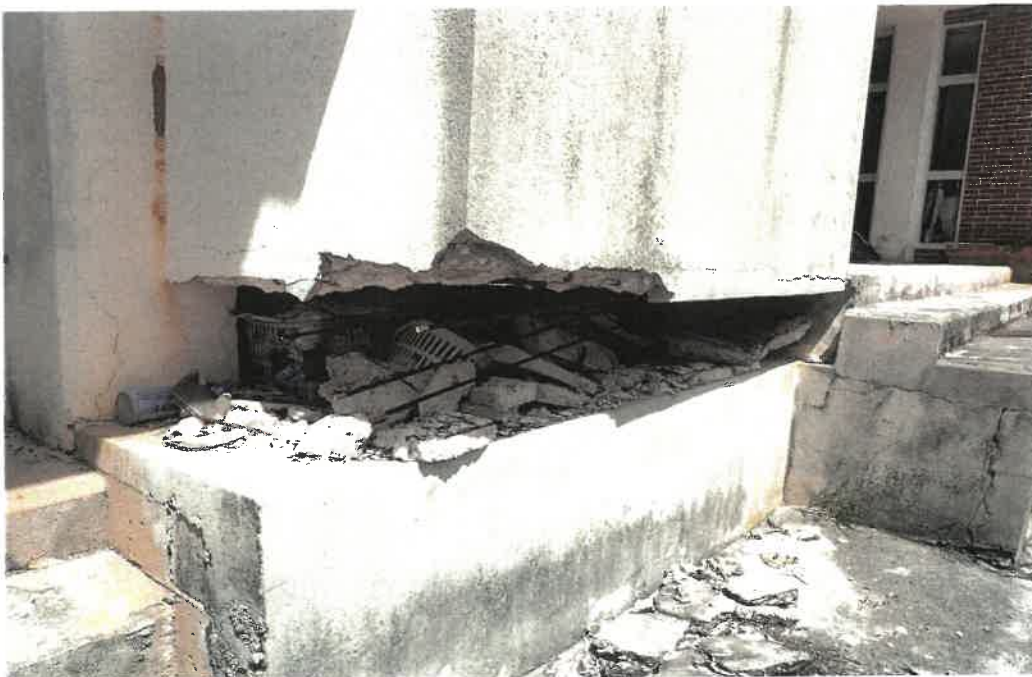
本件建物支柱の損壊等
