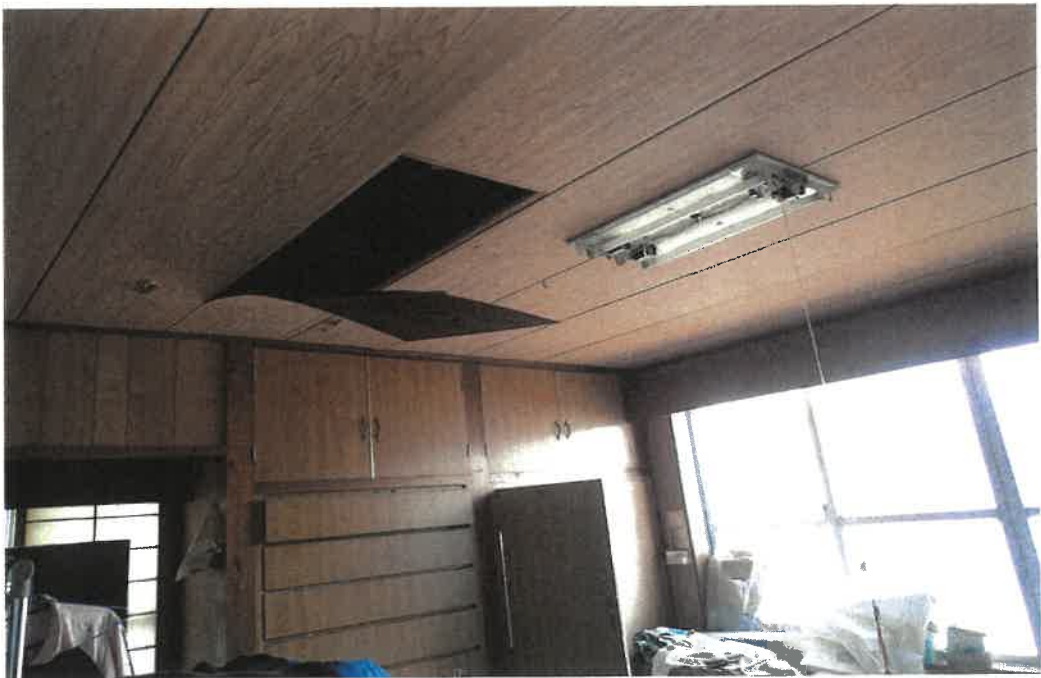
同上(天井板損傷状況)
