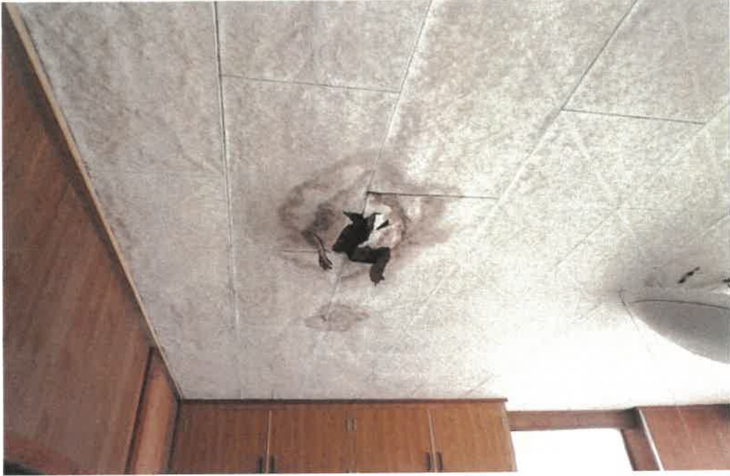
本件建物内部(天井板損傷状況)
