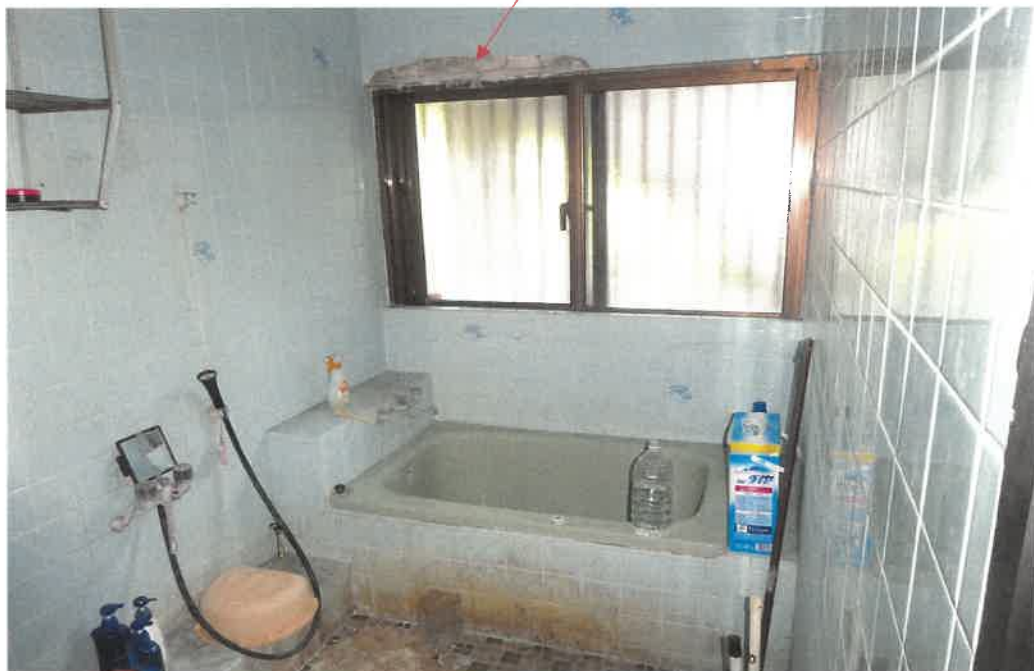
同上(一部タイルの剥がれた箇所あり)
