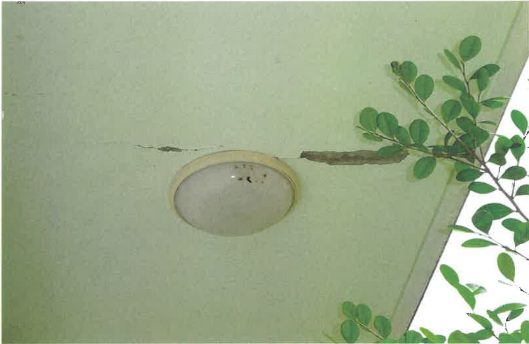
物件2(コンクリートの剥がれた箇所)
