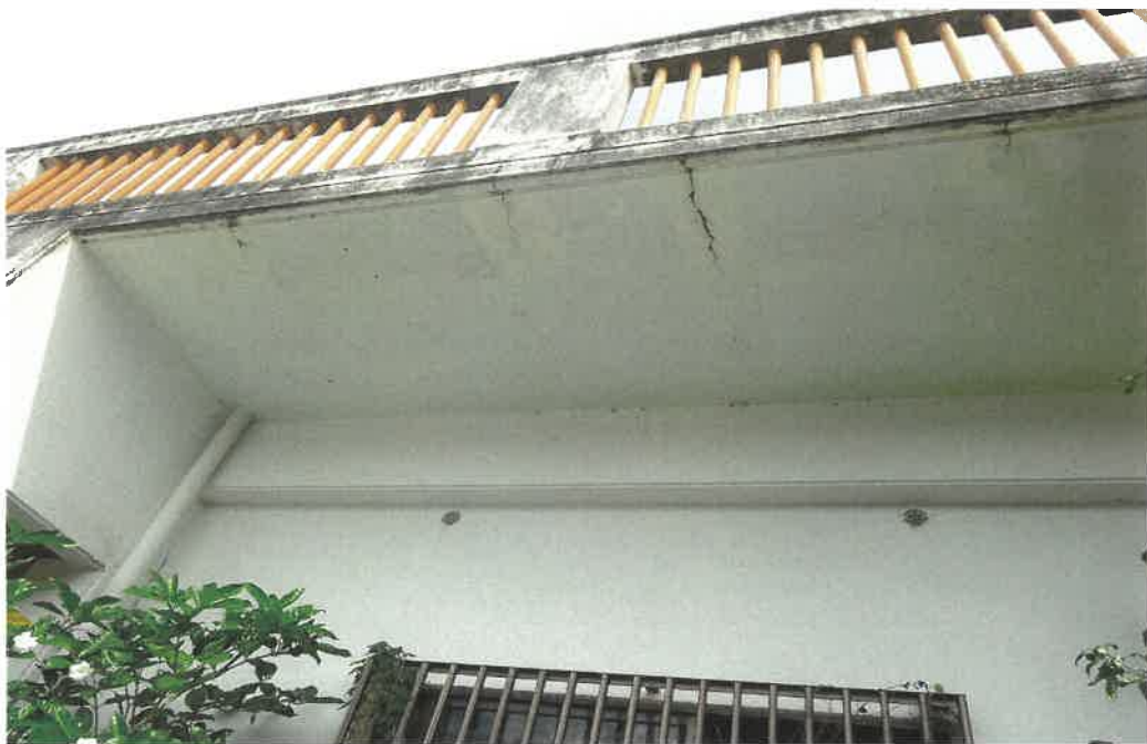
同上(コンクリートにできたひび)
