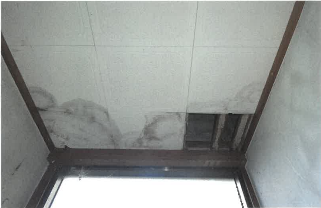
物件2の室内(以前雨漏りのあった箇所)
