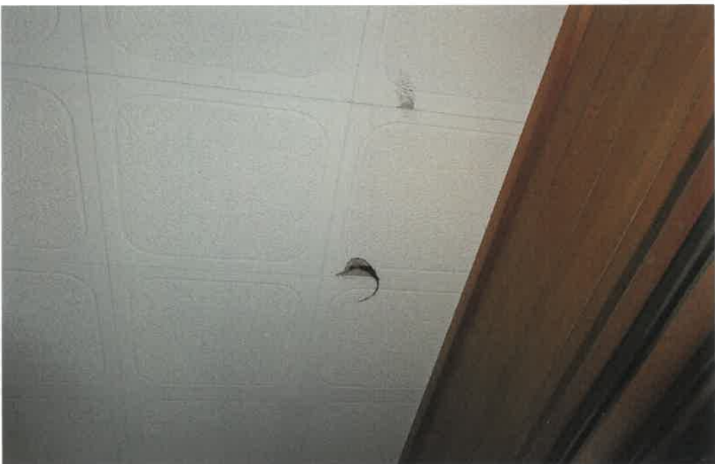
物件2の室内(天井にできた傷)
