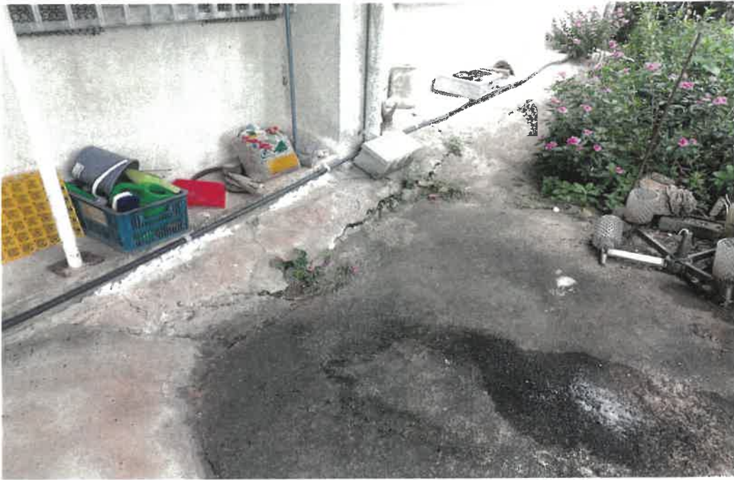
建物の東側敷地の陥没状況
