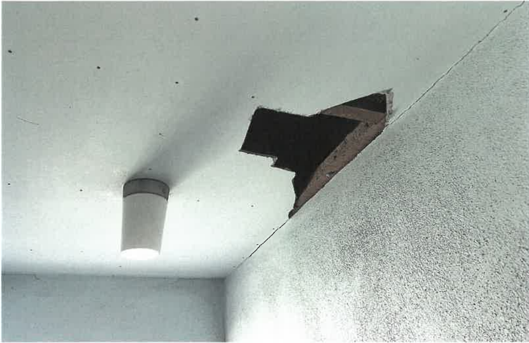
物件3の室内(トイレの天井の穴)
