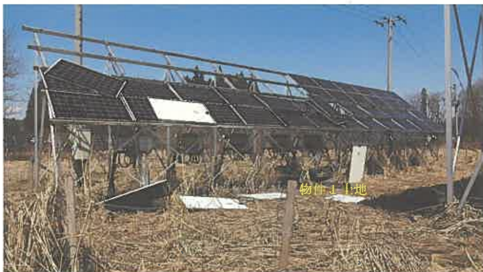
ソーラーパネルの破損・落下状況
