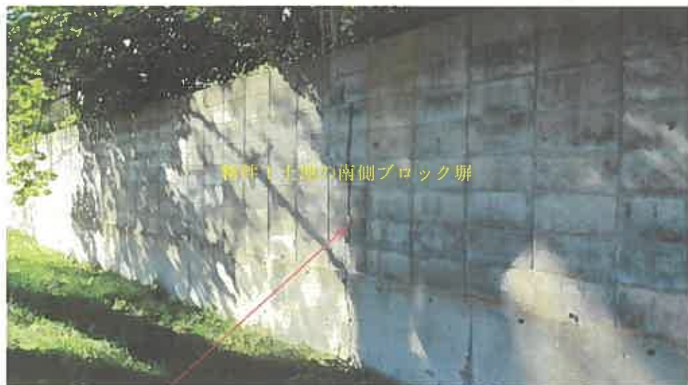
亀裂が生じている
