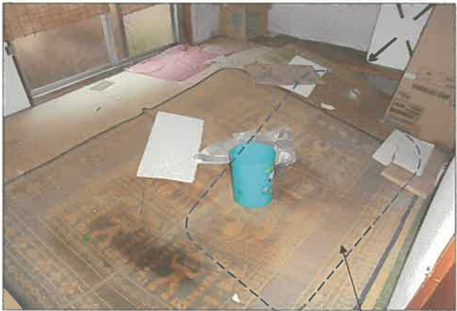
床が陥没している。
