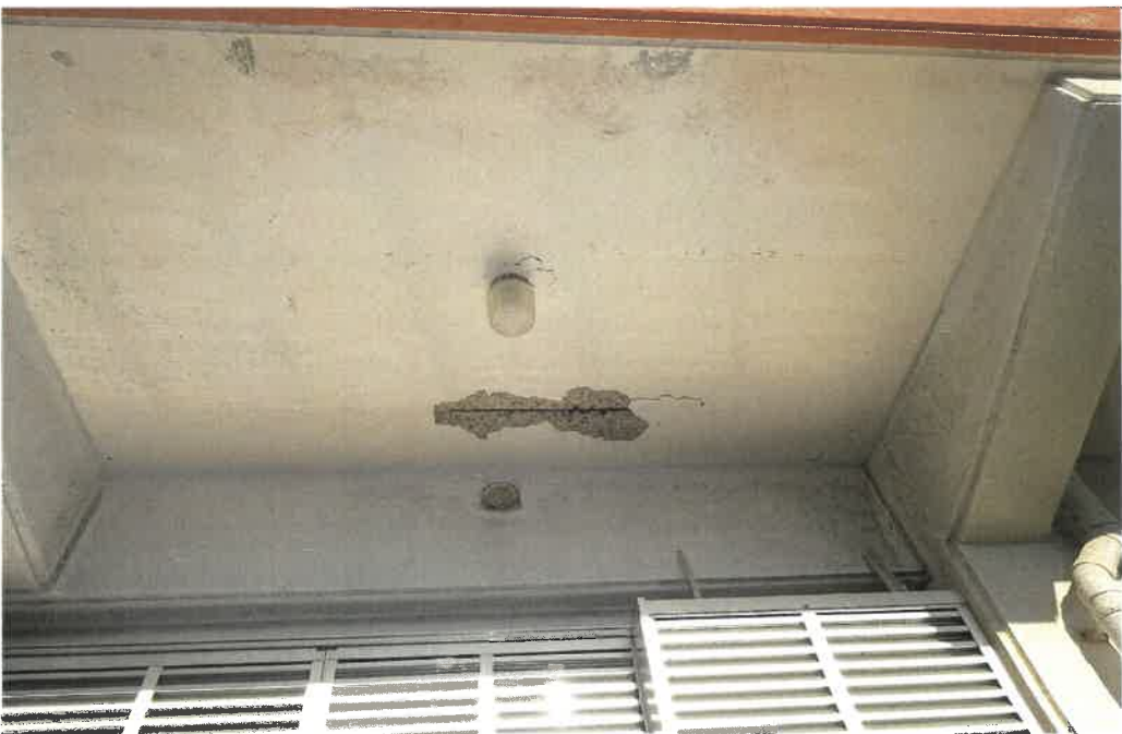
物件2(コンクリートが剥離した箇所)
