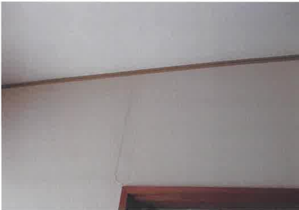
物件6:和室3の内壁クロスのひび等の状況
