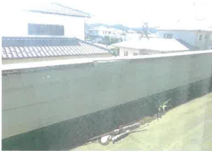
物件1:2階ベランダの状況
