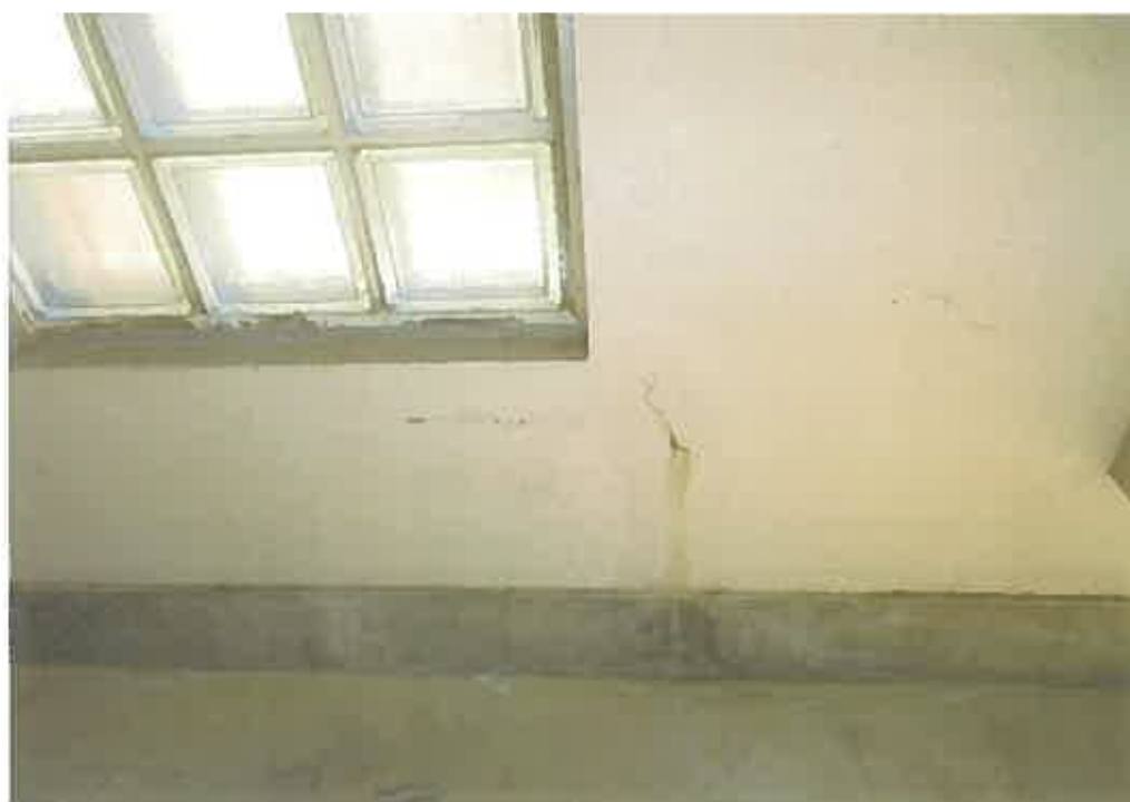
物件9:1階ホールの壁のひび等の状況
