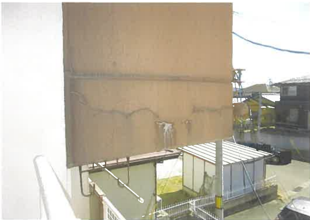
物件9:302号室バルコニーの外壁部分のひび等の状況
