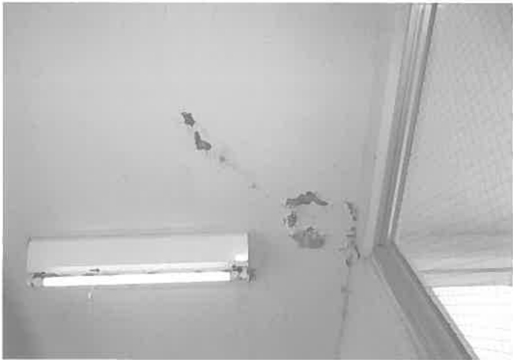
物件9:3階外廊下の天井部分の塗装の剥がれ等の状況
