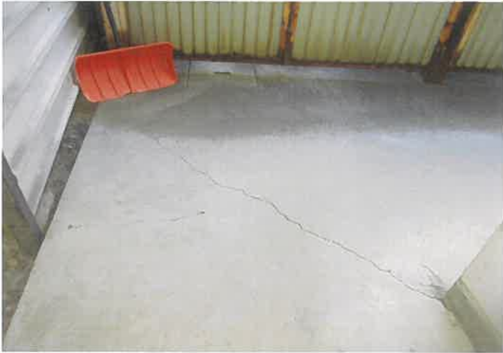
物件9:1階外廊下のひびの状況
