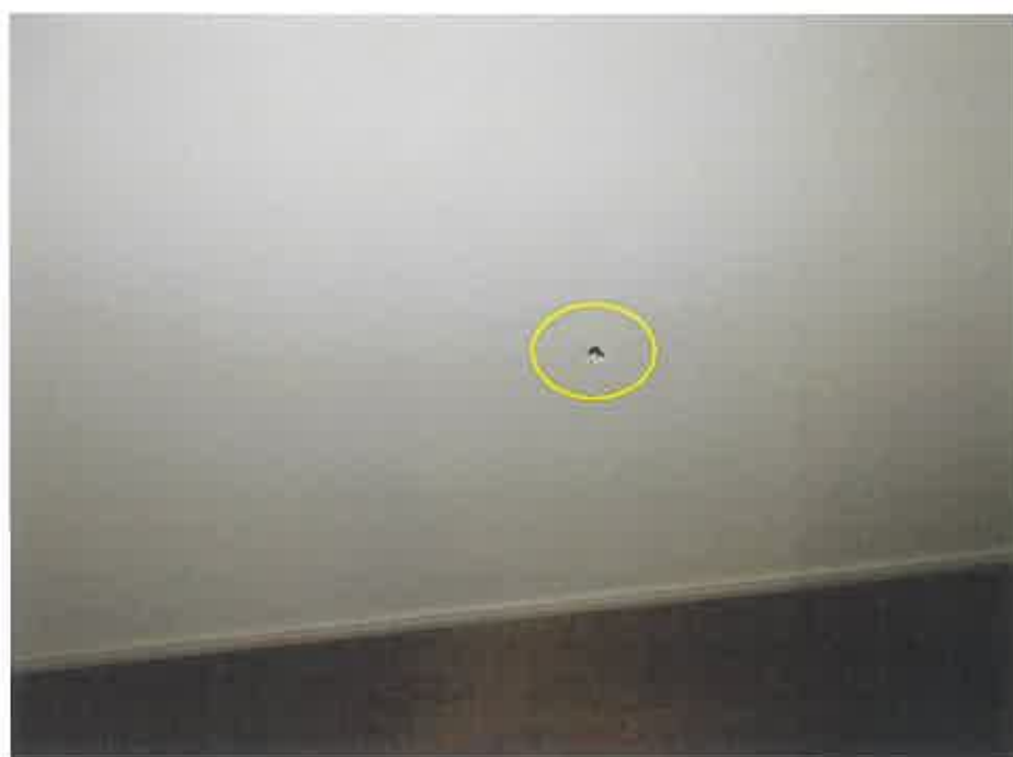
物件4:1階リビング・ダイニングの壁の穴 No. 10
