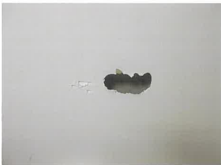
物件4:2階洋室Bの壁の破損状況 No. 9
