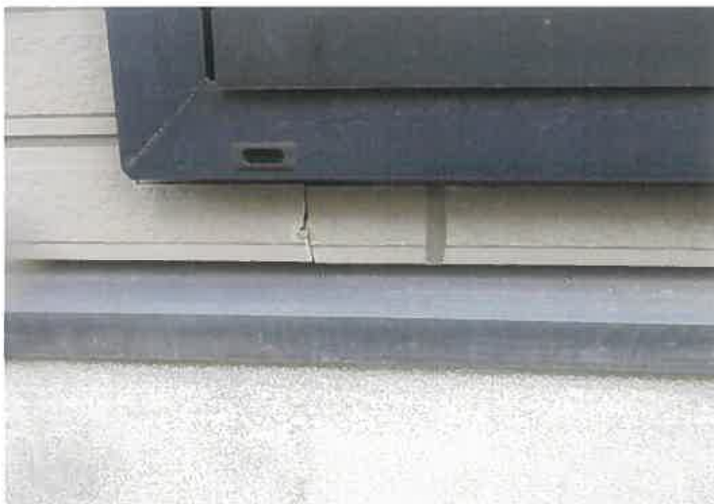
物件2:外壁のひびの状況
