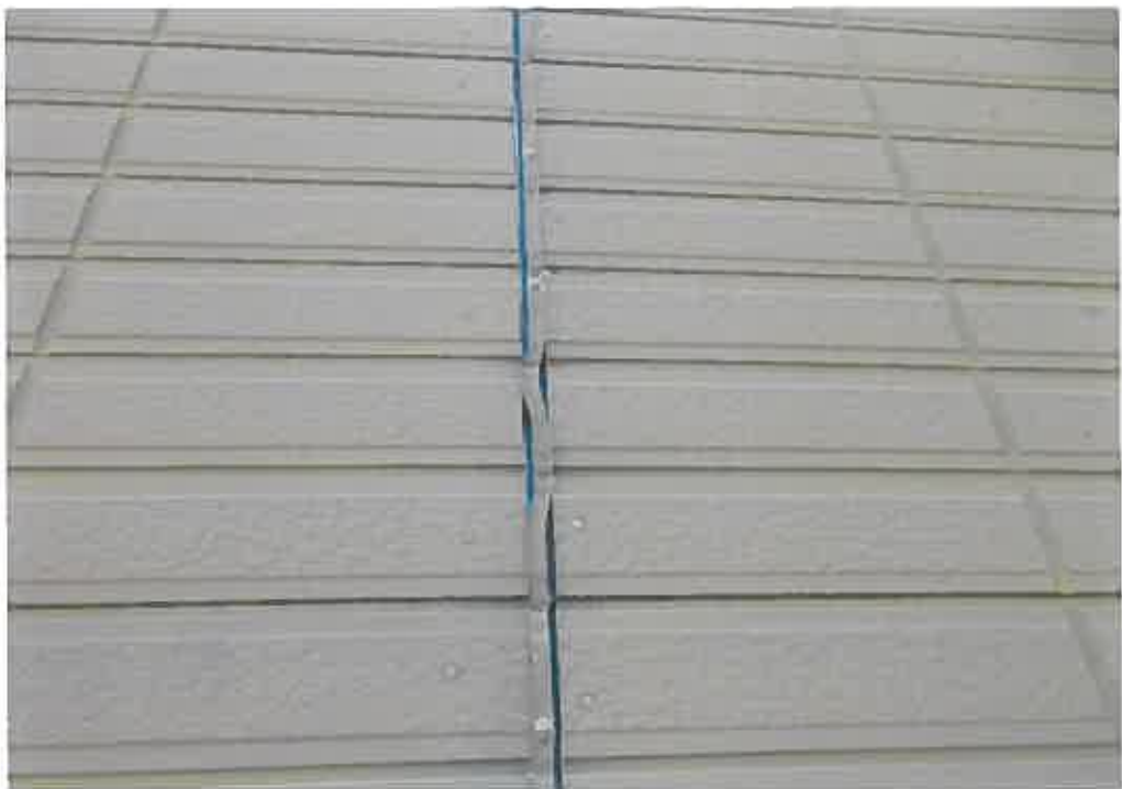
物件2:目地の損傷の状況
