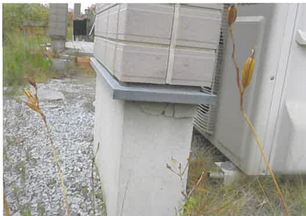
物件2:玄関ポーチの柱部分のひびの状況
