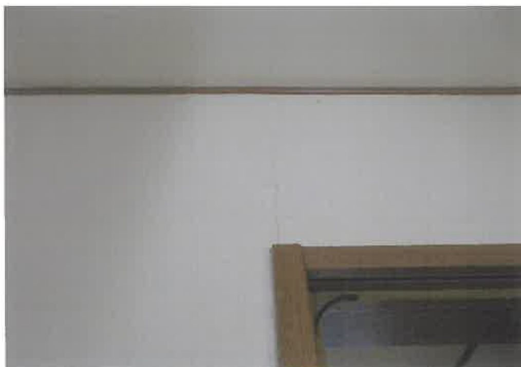
物件2:1階台所の内壁クロスのひびの状況
