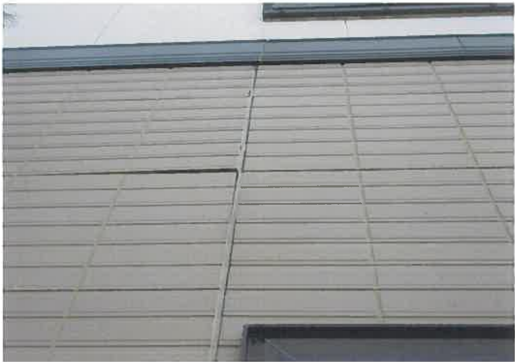
物件2:目地の損傷や外壁パネルのずれの状況
