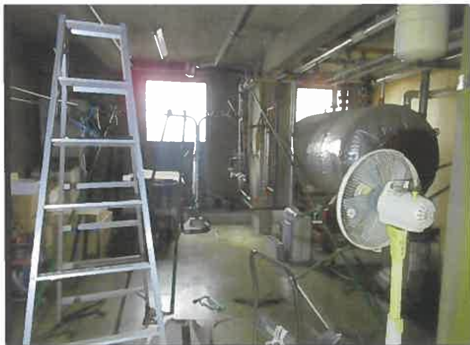
No. 18 物件5:主である建物 1階ボイラー室の状況
