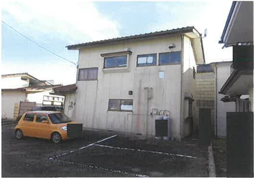
物件5附属建物符号2の外壁の汚損等の状況
