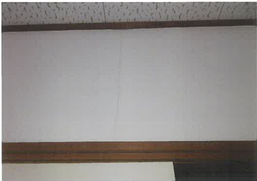
物件5附属建物符号2の2階板の間の内壁のひびの状況
