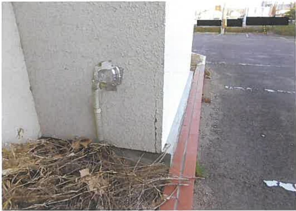
物件6専有部分の建物の外壁のひびの状況
