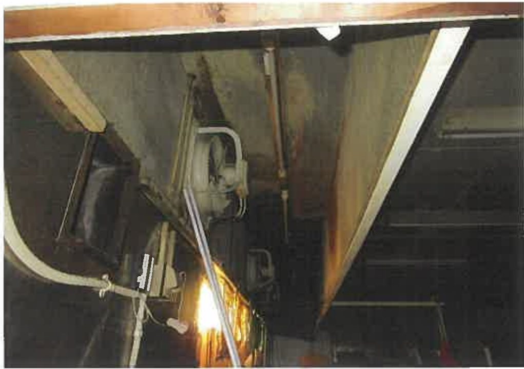
物件5専有部分の建物: 厨房の天井の腐食等の状況
