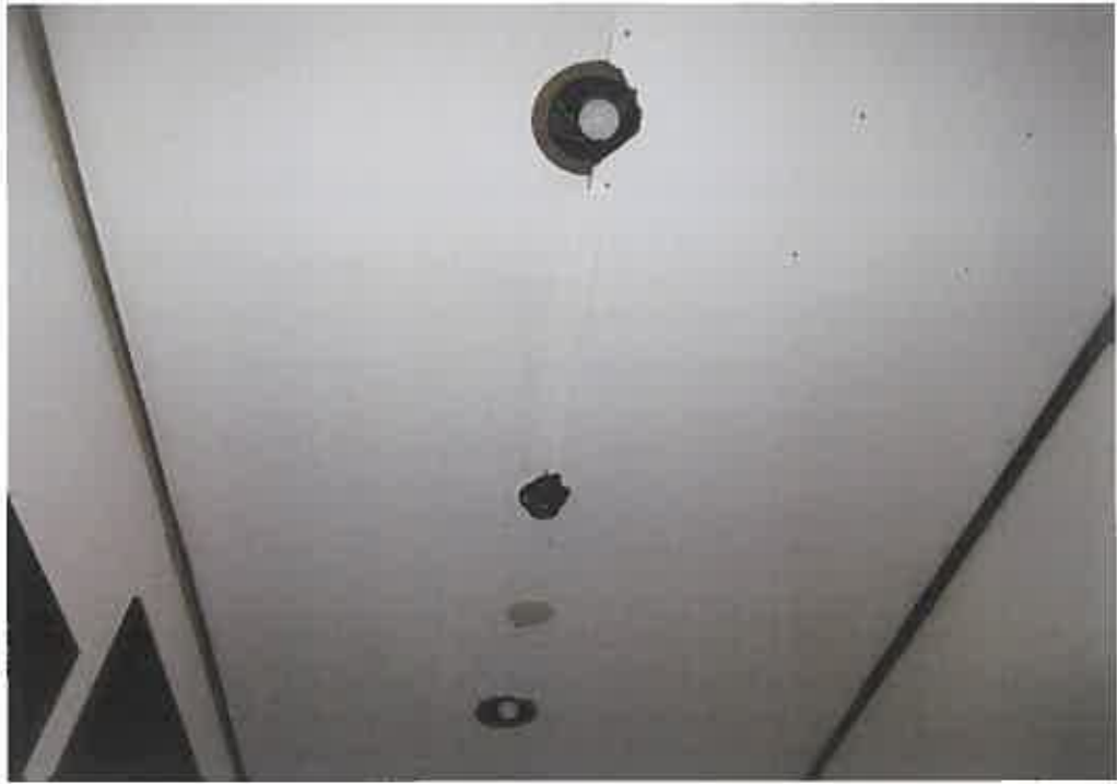
物件5専有部分の建物: 厨房側カウンターの東側 通路部分の天井の状況
