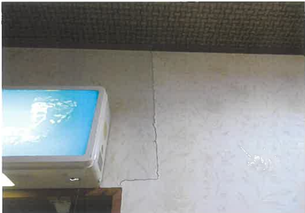
物件5専有部分の建物: 厨房と大広間の間の通路部分 の内壁クロスのひびの状況
