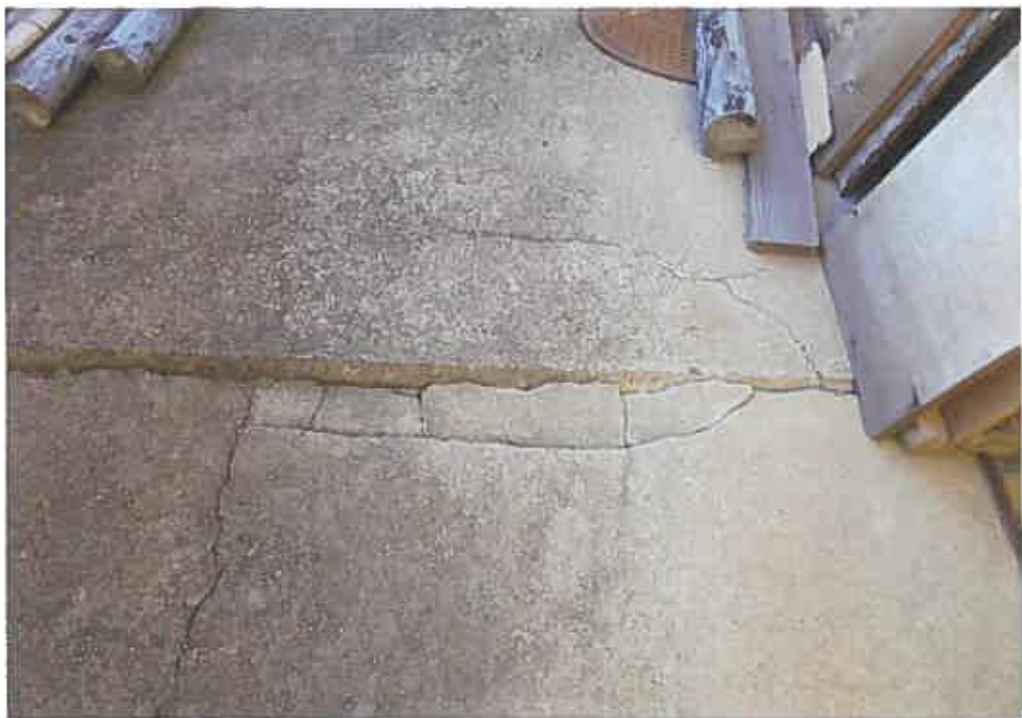
物件2土地南側のコンクリートの亀裂と段差の状況
