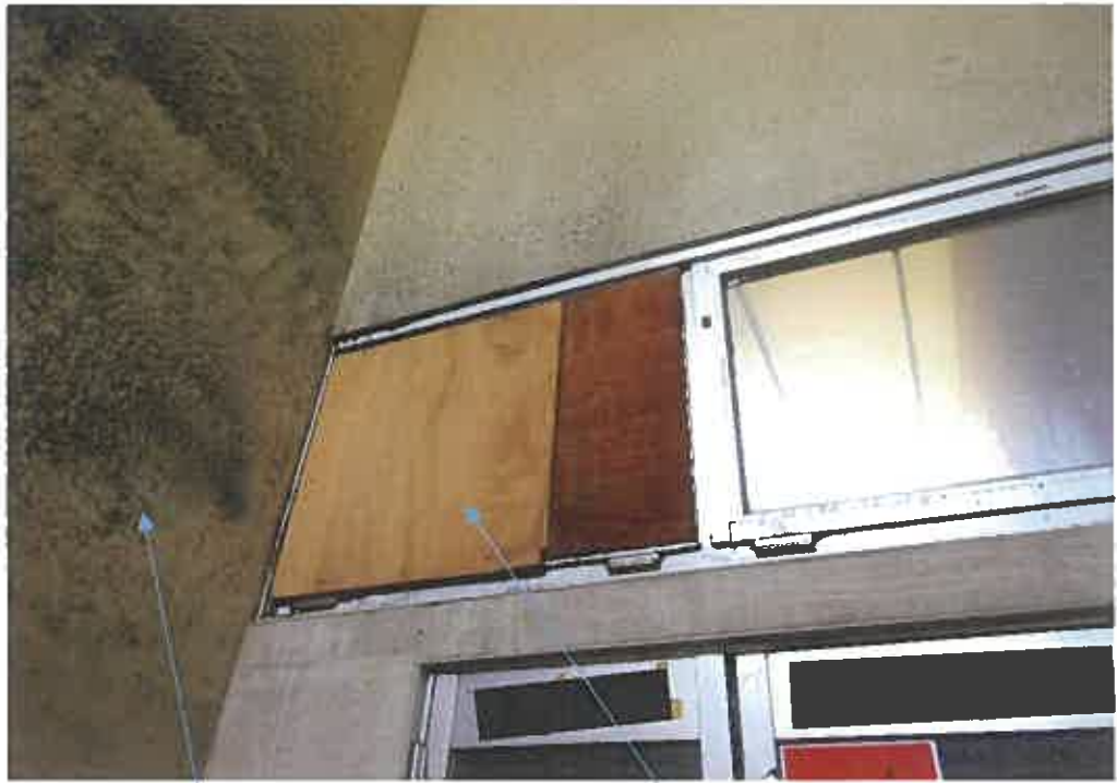
物件5専有部分の建物の外壁 の汚損
