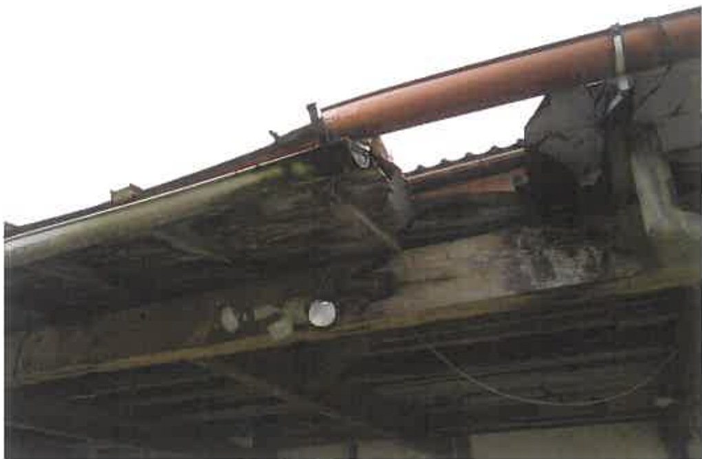
物件3:下屋部分の損傷等の状況
