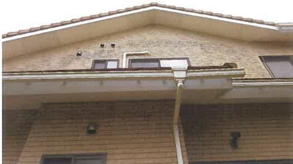
物件2:外壁の汚れ等の状況
