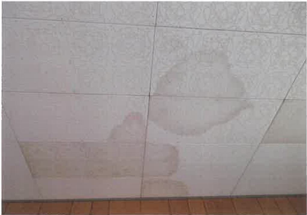
物件3:2階洋間の天井のシミの状況
