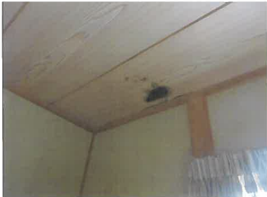
物件2:1階北西側和室の天井の状況 (上階のユニットバス・トイレからの水漏れと思われる) No. 10
