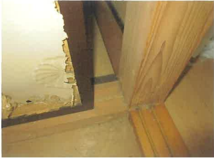
物件2:1階南東側和室の建具・柱の状況 No. 9
