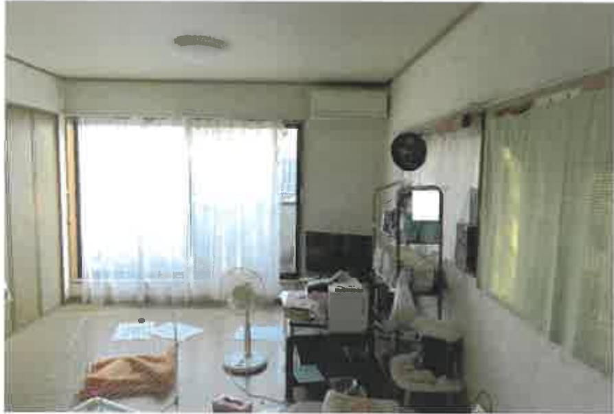
物件2:2階南西側洋室の状況
