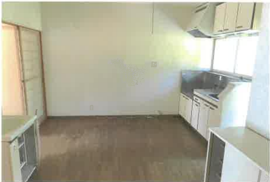
物件2:2階G号室ダイニングキッチンの状況
