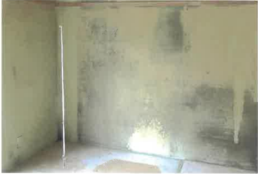
物件2:1階D号室和室北東角の状況
