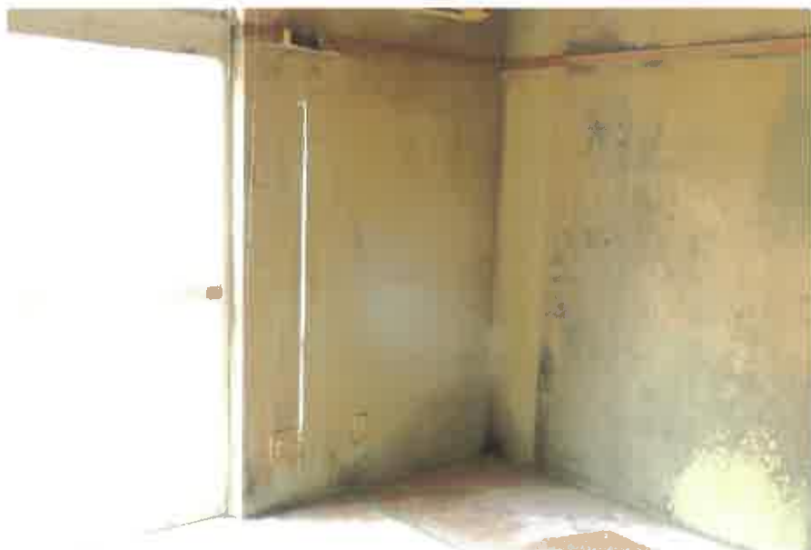
物件2:1階D号室和室南西角の状況
