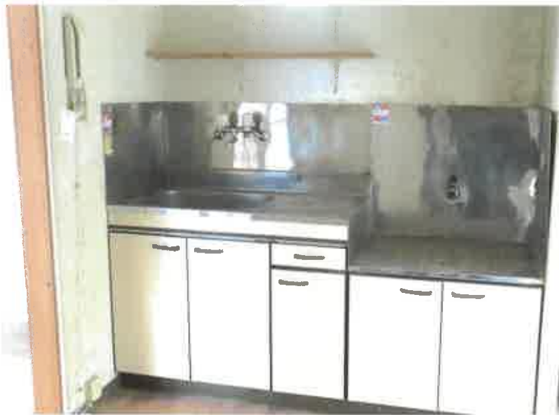
物件2:1階E号室キッチンの状況
