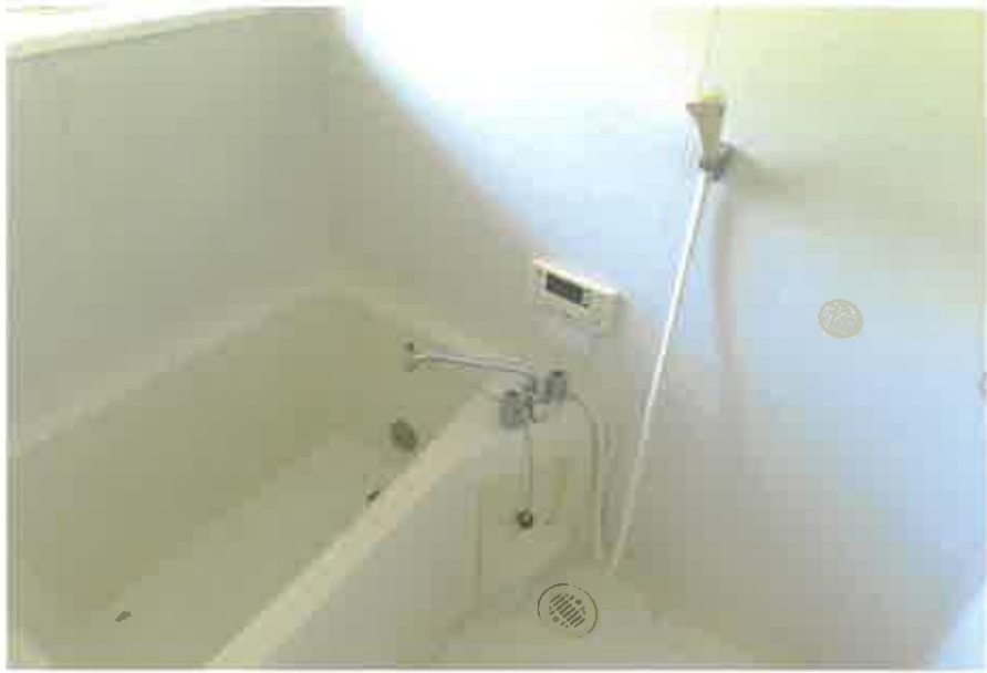
物件2:2階G号室浴室の状況
