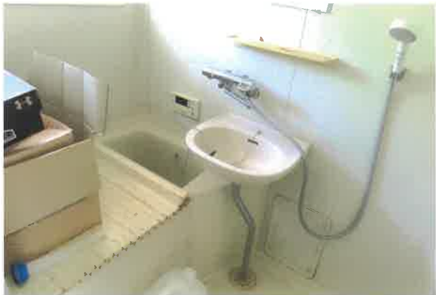
物件2:2階J号室浴室の状況
