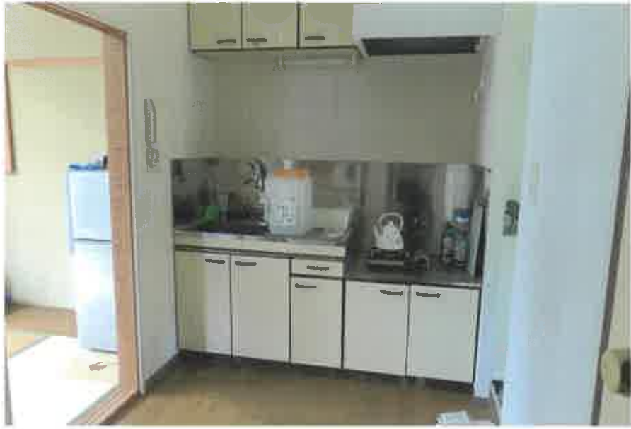
物件2:2階J号室キッチンの状況
