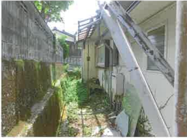
窓ガラスが割れたサッシ
