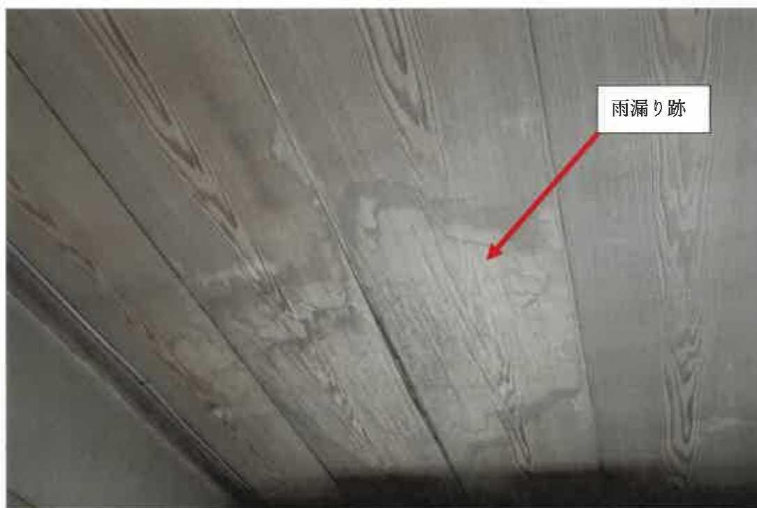
写真⑫ (洋室天井・雨漏り跡)
