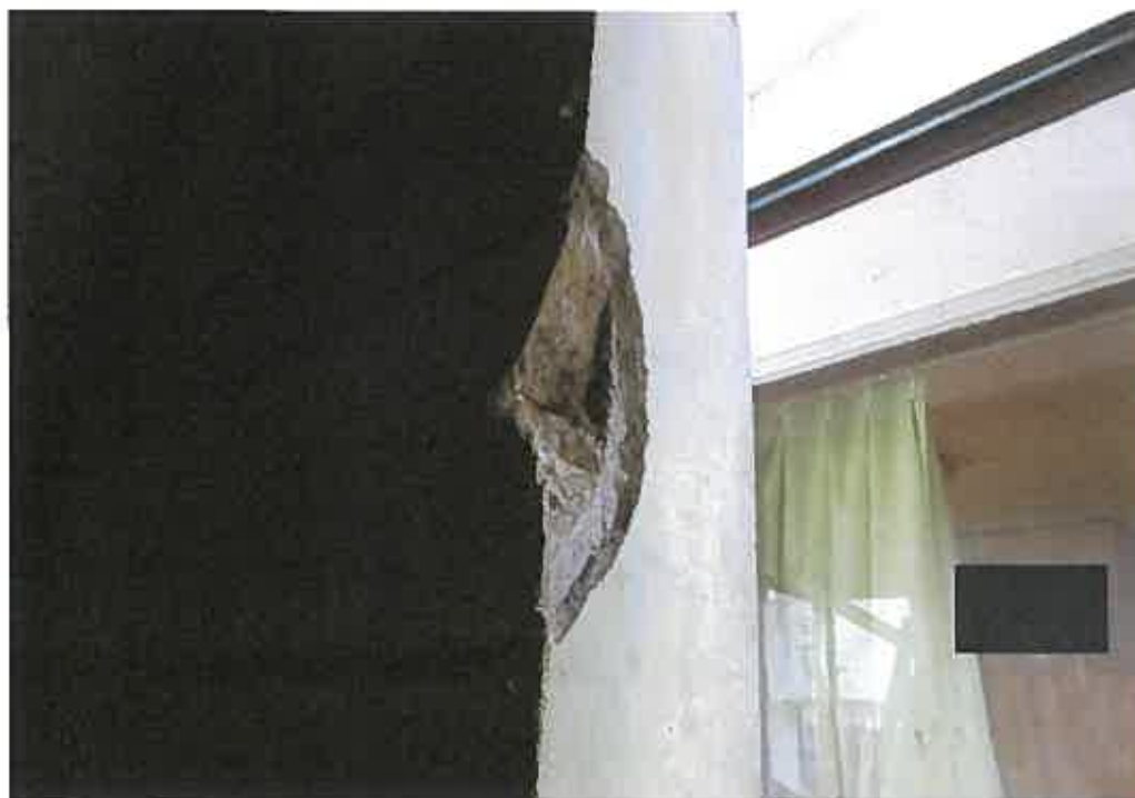
物件3附属建物:壁の損傷の状況
