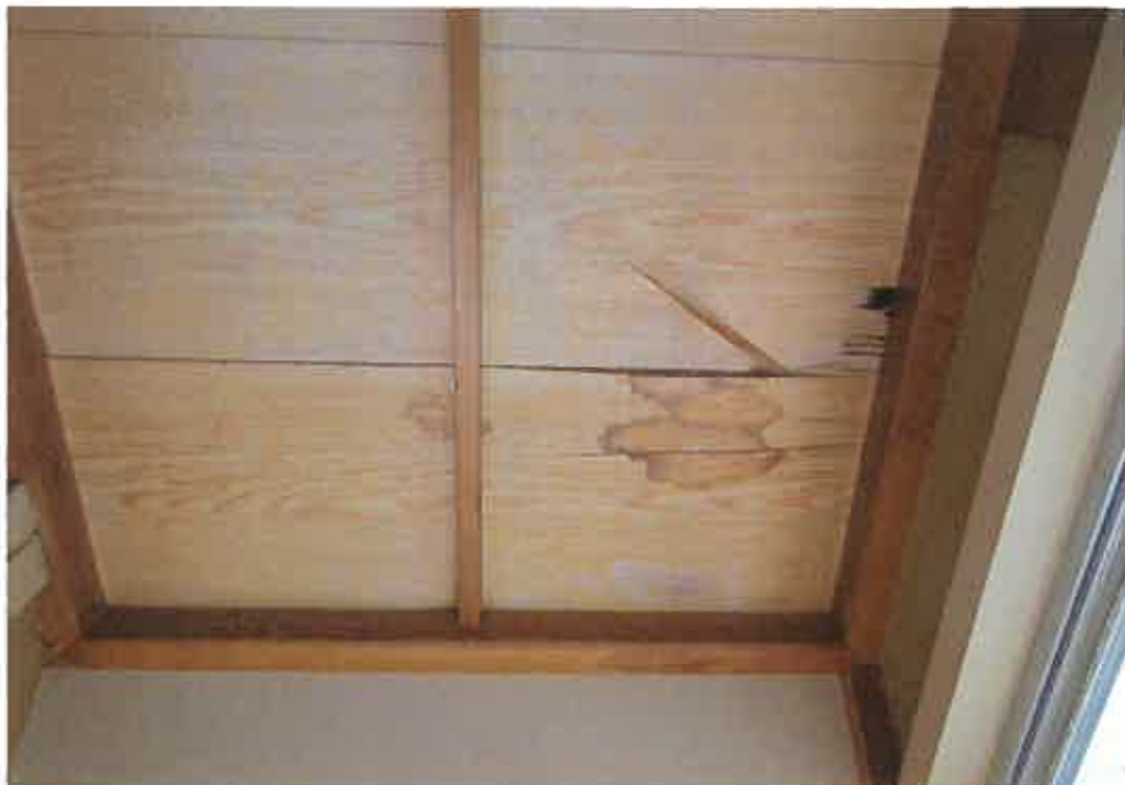
物件3主である建物:1階広縁の天井のしみや損傷の状況
