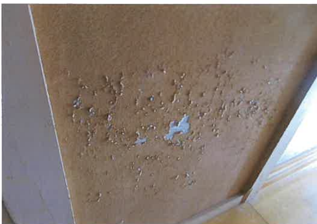
物件3主である建物: 1階廊下内壁の猫による引っ掻き傷の状況
