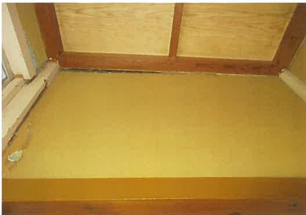
物件3主である建物: 1階広縁の内壁の損傷等の状況
