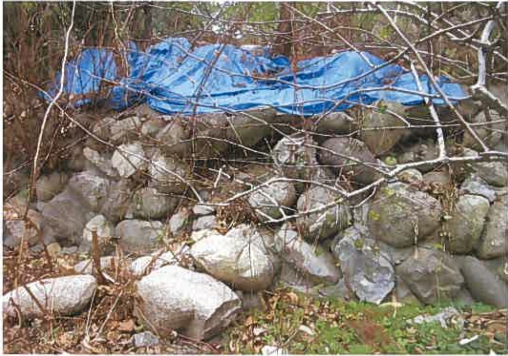
物件1:法面部分の石の崩落状況
