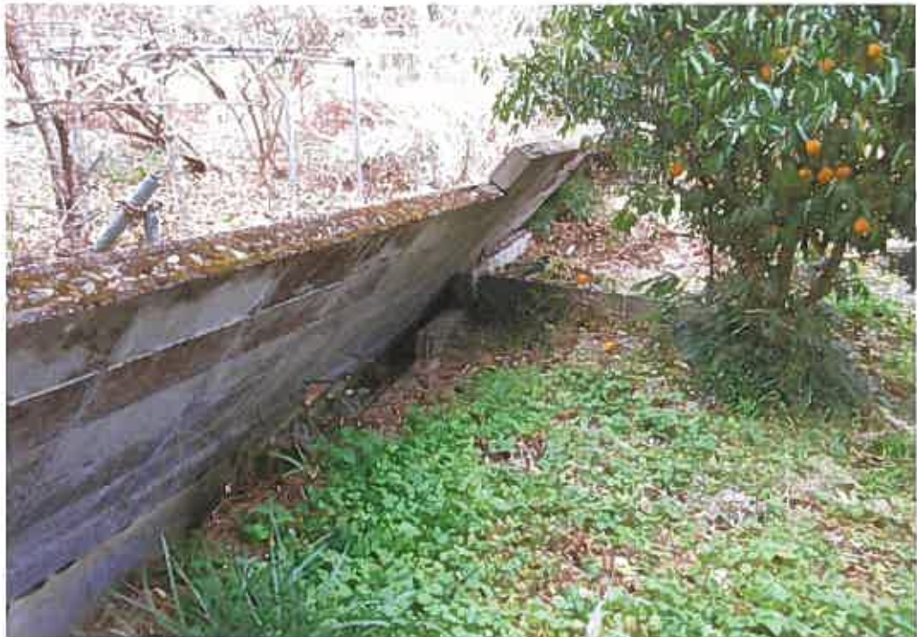
物件1:ブロック塀が傾いている状況
