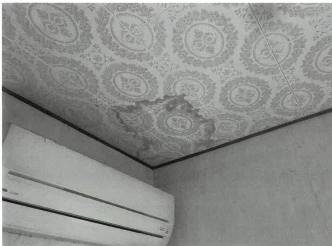
物件2（主である建物）内部 1階洋室天井の雨染み
