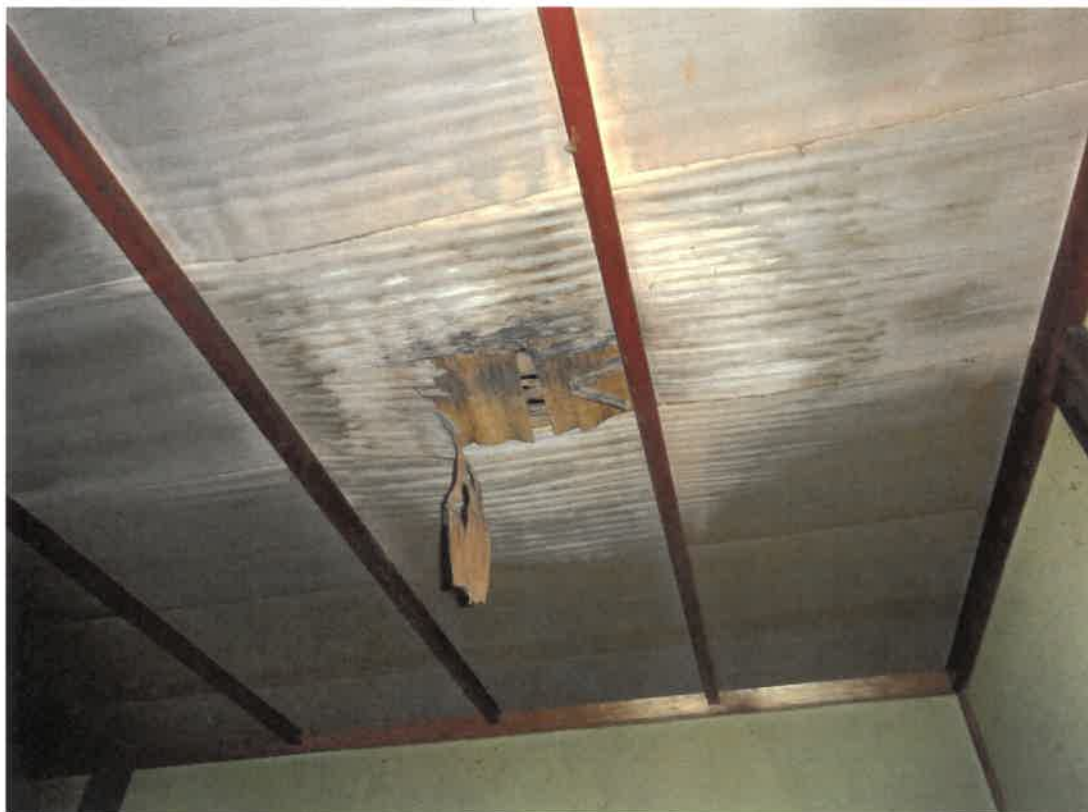
物件2（主である建物）内部 1階和室天井の雨漏りによる劣化箇所
